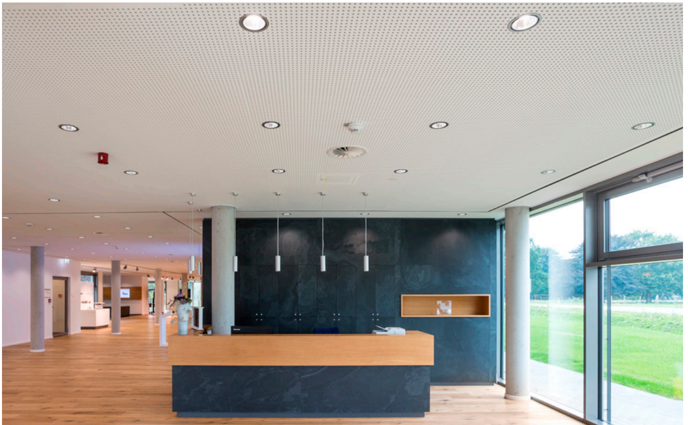
Fig. 7: Plafond climatisé avec plaques de plâtre perforées et diverses installations (lumière, air, sprinkler, détecteur de fumée)
