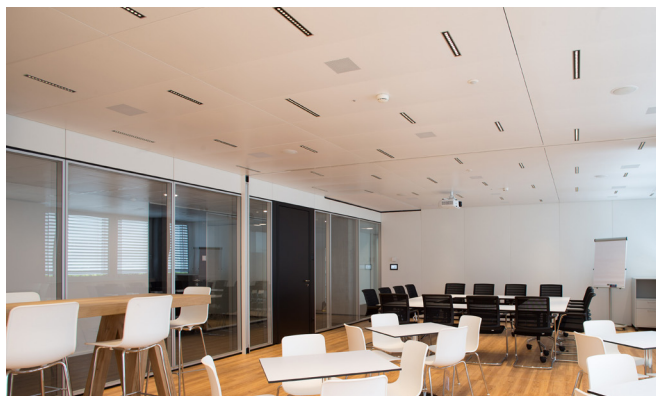
Plafond rayonnant métallique
